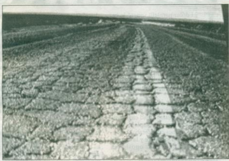
En un trayecto de la vía tanto el estado del asfalto como la cartelería están en malas condiciones.
